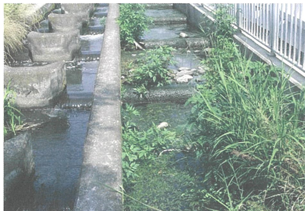
写真3 土砂が堆積した魚道
