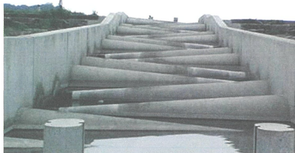
写真4 流入水がない魚道
